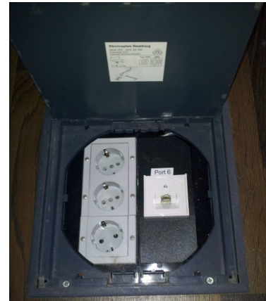
Unterbodenversorgung (Strom und Netzwerk)
