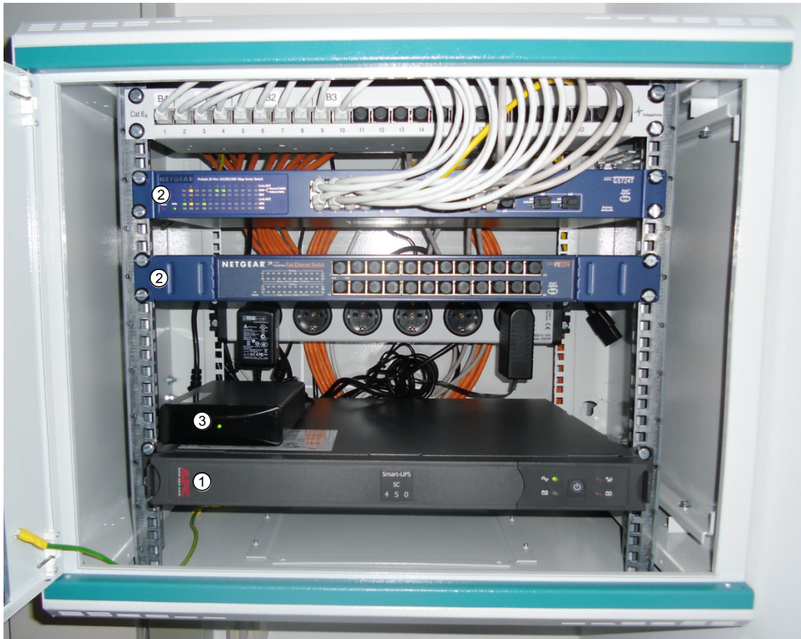
Die USV ① versorgt neben den beiden Switches ② auch eine USB-Backup-Platte ③ sowie eine (nicht auf der Abbildung sichtbare) FRITZ!Box
